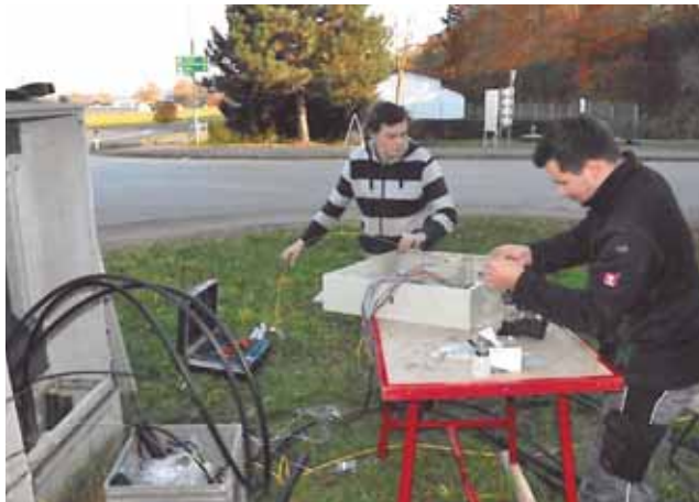
Durch die neue Technologie ist der Wartungsaufwand für Expert Nöhmer deutlich gesunken. Das notwendige Know-how für die Wartung des Glasfasernetzes, wie das Spleißen der Lichtwellenleiter, hat sich Gerhard Nöhmer junior bereits angeeignet. (Foto: Expert Nöhmer)
