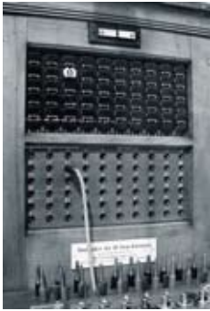
Telefon-Handvermittlung („Klappenschrank“), (Objekt des TMW)
