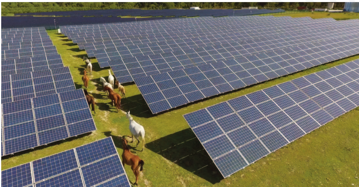
14 MW, Coruche, Santarém, Portugal.
